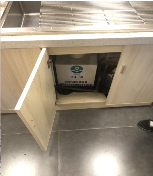
图 3-2 污水处理装置
