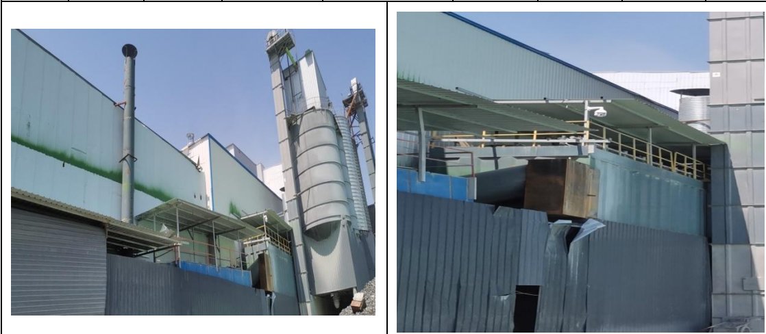
图 5 废气处理设施(排气筒)
