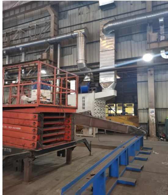
图 6 焊接工位配套的中央除尘设施
