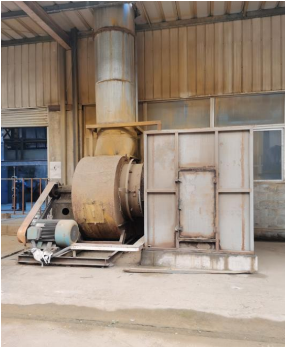
图 9 底漆工序排气筒 (DA003)
