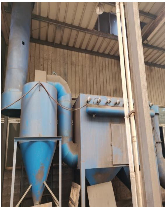
图 7 抛丸机配套的袋式除尘器+排气筒 (DA001)
