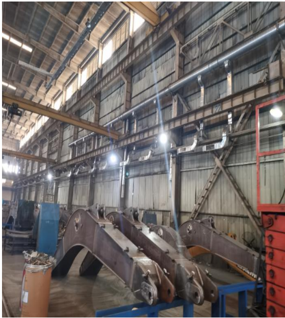
图 5 焊接工位配套的中央除尘设施
