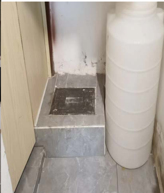
图 3-2 污水处理装置（混凝沉淀池+事故罐）
